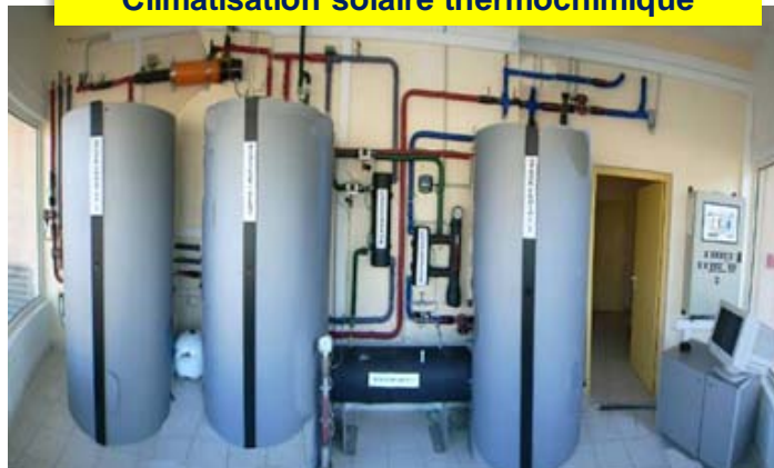
Climatisation solaire thermochimique
